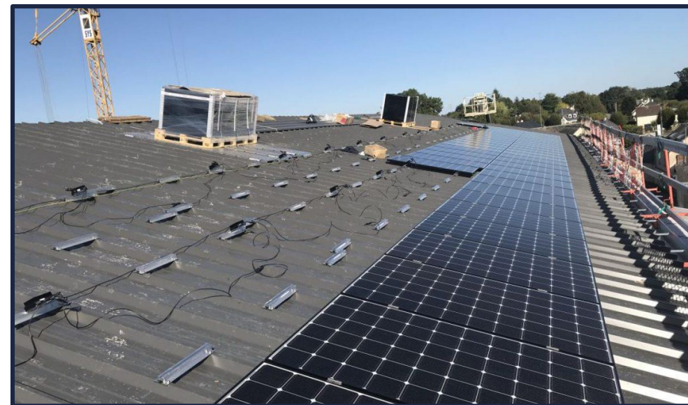
Panneaux photovoltaïques sur la salle FCC
